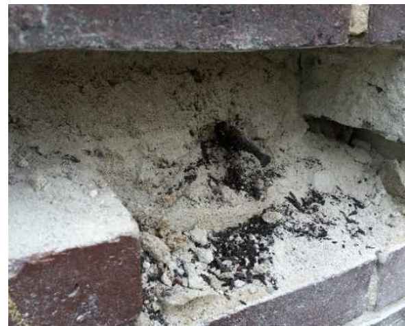
Figur 48 Korrosionsprodukter viser sig som rustflager.
