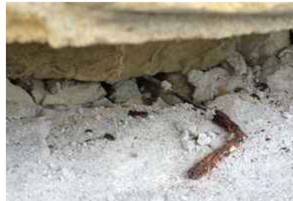
Figur 47 Korrosion af murbinder i hulmur.
